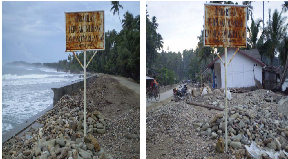
Gambar 2.4. Tembok Penahan Ombak dan Gelombang Laut yang Terancam Hancur Photo : Oktober 2007, Kecamatan Telukdalam-Nias Selatan
