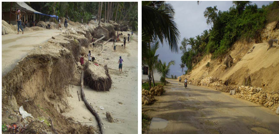
Gambar. 2.3. Badan jalan yang terkena longsor Photo : Oktober 2007, Kecamatan Telukdalam-Nias Selatan
