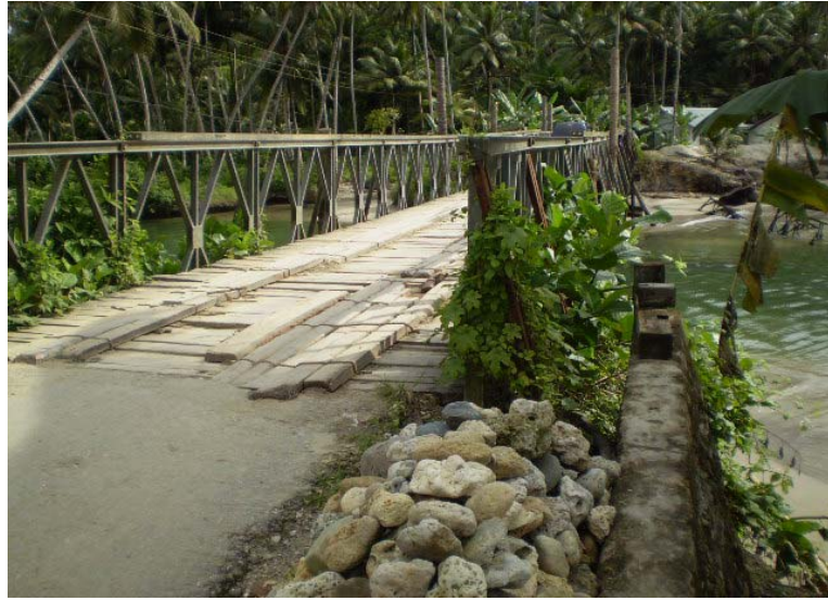
Gambar. 2.6. Jembatan yang terancam ambruk Photo : Oktober 2007, Kecamatan Telukdalam-Nias Selatan
